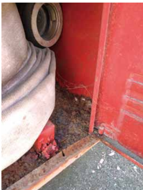
塩害と経年劣化で腐食
