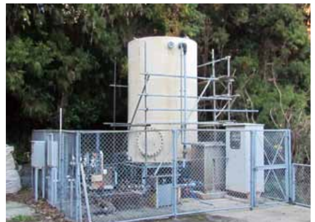
「みちしおの湯」の泉源施設
