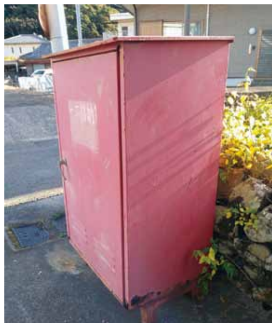
消火用ホース格納箱
