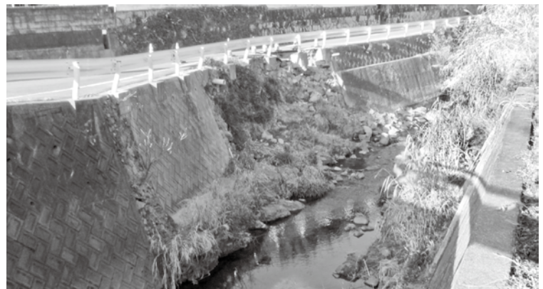
復旧工事を待つ被災した道路（原谷）
