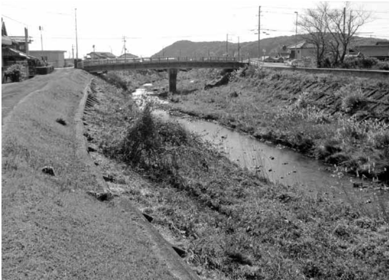
早急に浚渫及び改修が望まれる
