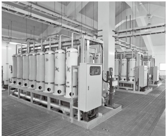
修繕が必要な浄水設備
