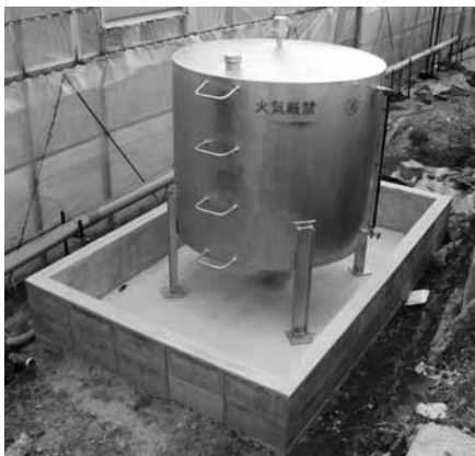
油の流出を防止する防油堤(タンク下の囲い)
